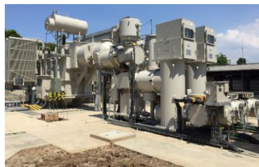
ITS受変電設備
