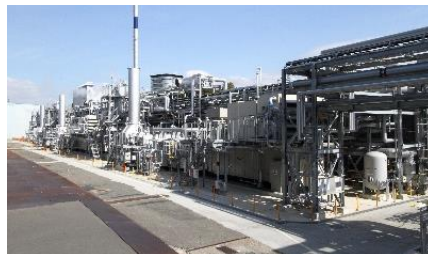
三島工場 コージェネレーション設備
