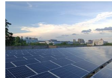
2020年度に太陽光発電設備を導入したTPPZ
