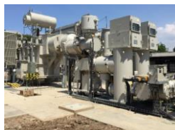
ITS受変電設備
