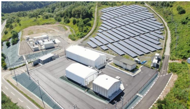
水電解プラント
