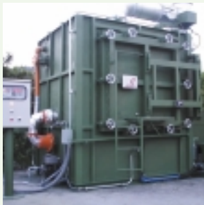
岐阜県美濃加茂市のゴルフコースに設置したバッチ式炭化装置
