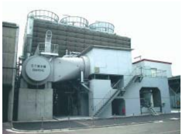
東海工場に設置した超低圧蒸気発電機
