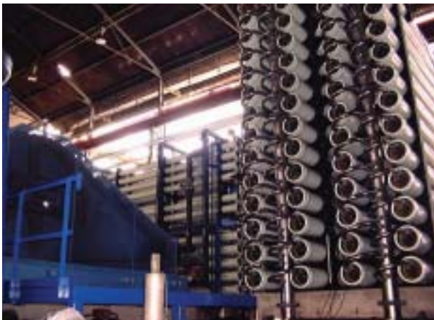
海水淡水化プラント
