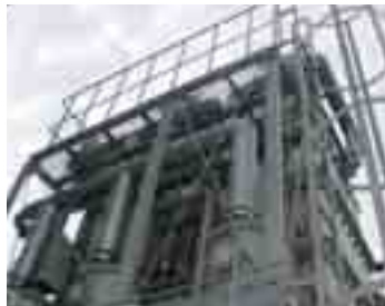
愛媛工場に設置した有機系排ガスの吸着回収装置
