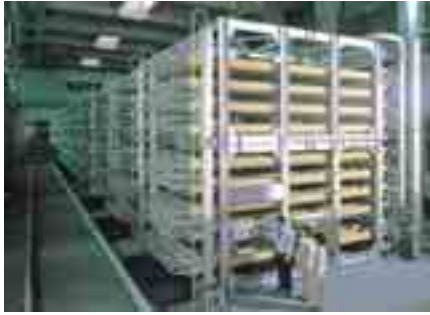
逆浸透膜“ロメンブラ”を使った海水淡水化プラント
