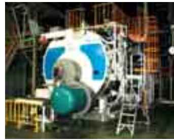
岡崎工場の天然ガスボイラー
