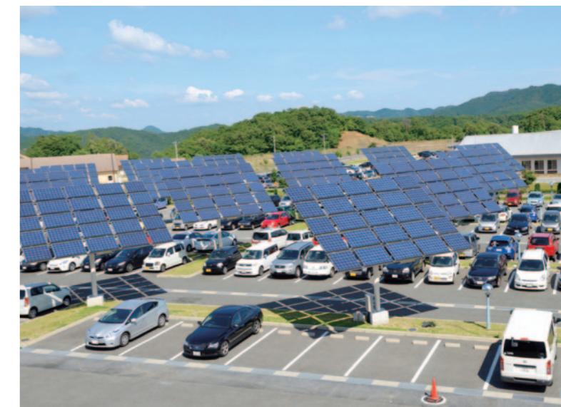
フジプレアム(株)が独自開発した「太陽追尾型発電システム」。パネルの下のスペースを他用途に活用できるため、地上設置型タイプと比べて土地の使用効率が高くなります。また、太陽の位置を算出して、太陽光パネルが自動で太陽を追尾するため、パネル固定型に比べて発電効率も高くなります。
