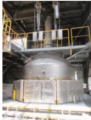
東レ(株)東海工場のN 2 O触媒分解処理設備
