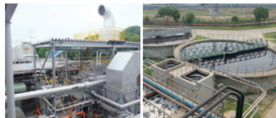
東レ(株)岐阜工場のガスボイラー 東麗酒伊織染(南通)有限公司の排水処理設備
