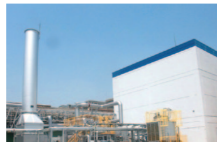
東レ(株)岡崎工場のコジェネレーション設備
