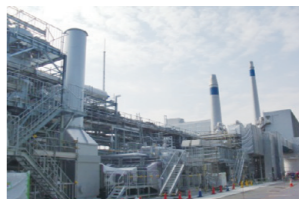
東レ(株)三島工場のコジェネレーション設備
