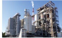
バイオマス燃料増量設備 (東レ(株)東海工場)
