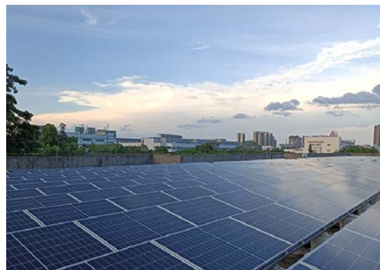
東麗塑料精密（中山）有限公司（TPPZ）の太陽光発電設備
