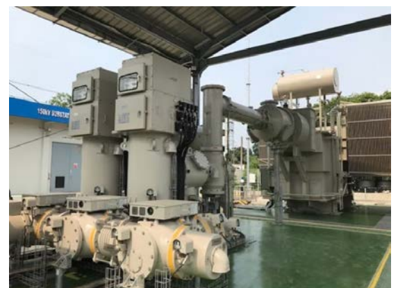
P.T. Indonesia Toray Syntheticsの受変電設備
