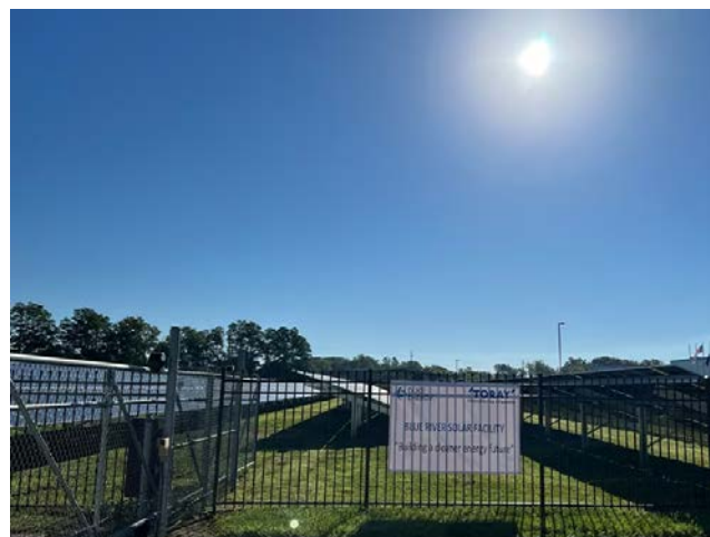
Toray Resin Co.（米国）の敷地内に設置した太陽光パネル
